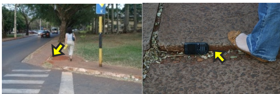
Figura 4 – Condições ruins e falta de manutenção dos pisos
