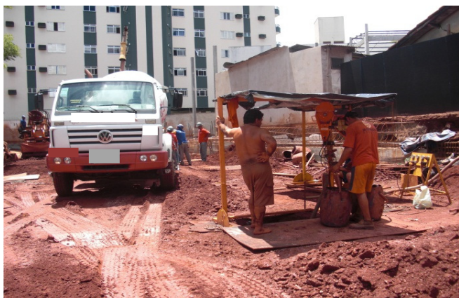
Figura 4 – Proximidade na execução de serviços de concretagem e alargamento da base de tubulões
