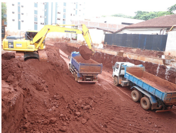
Figura 7 - Escavação sem sinalização
