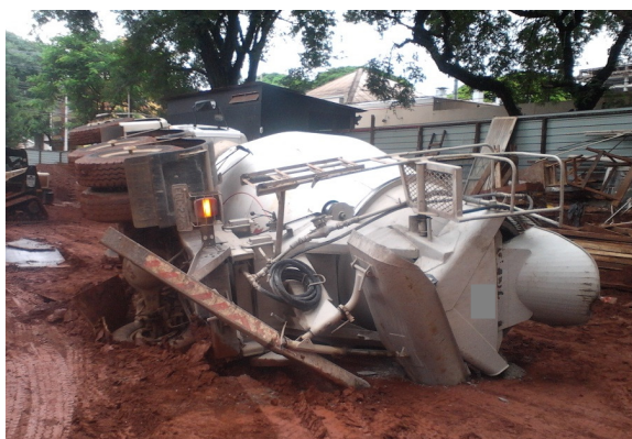
Figura 9 – Queda do caminhão betoneira no interior do fuste do tubulão perfurado
